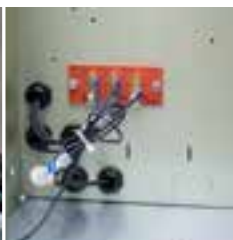
Tablilla de conexiones
